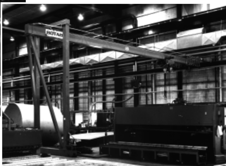
Halvportalkran för 2 tons last och 11 m spännvidd.
